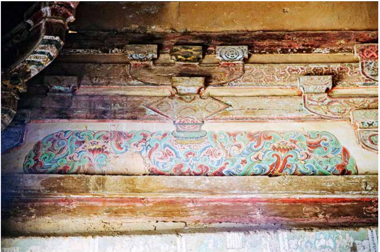
开化寺大雄宝殿补间铺作彩画实物现状照片：西壁南次间
